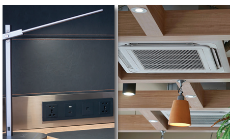
Stikkontakter til arbejdspladser
